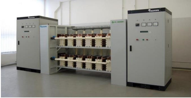
Общий вид установки Э-5
